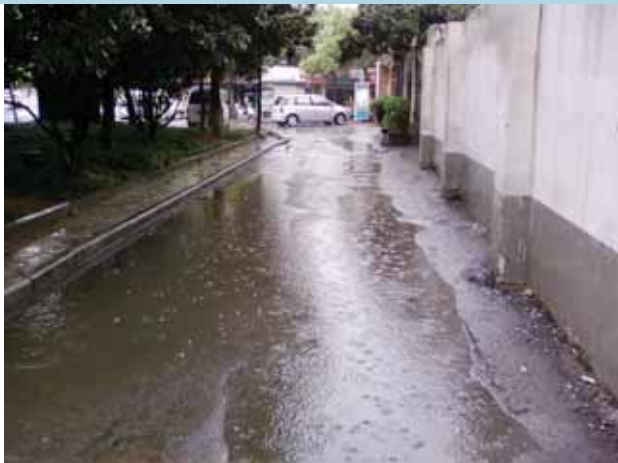
图1：维修前的道路
